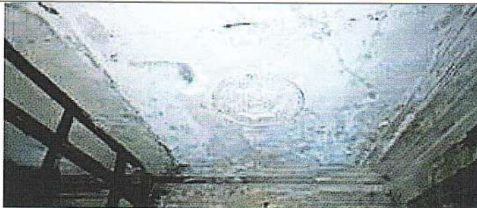
Рис.11-12. Розетка на потолке помещения второго этажа
