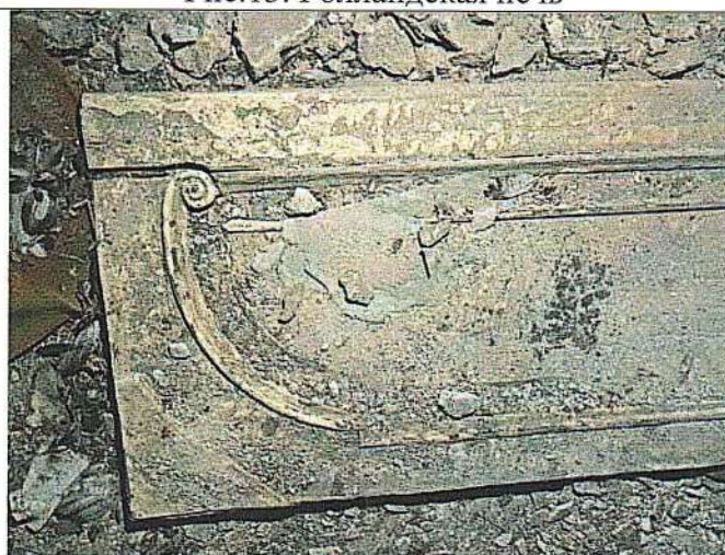
Рис.14. Обрушенная дверь помещения второго этажа
