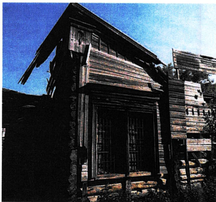
Рис. 34. Оставшаяся часть карниза храмовой части южного фасада
