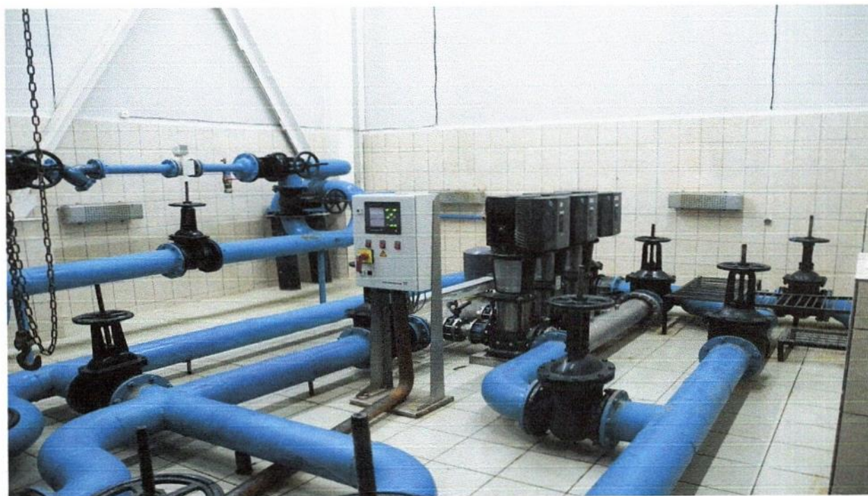
Фото 6. Насосная станция (II подъема).
