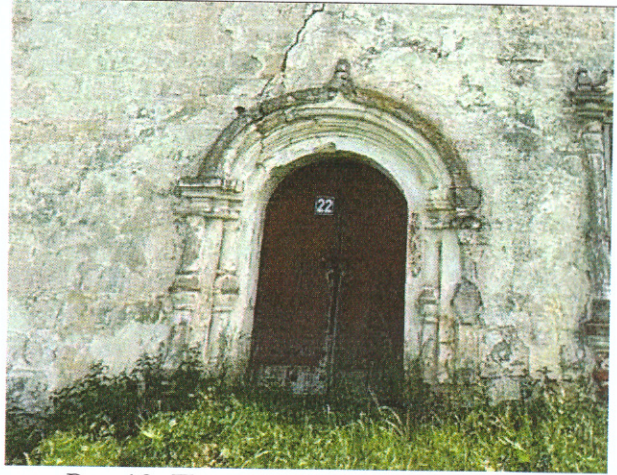
Рис.13. Портал с северной стороны
